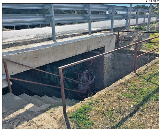
La barana no compliria les mesures de seguretat.
